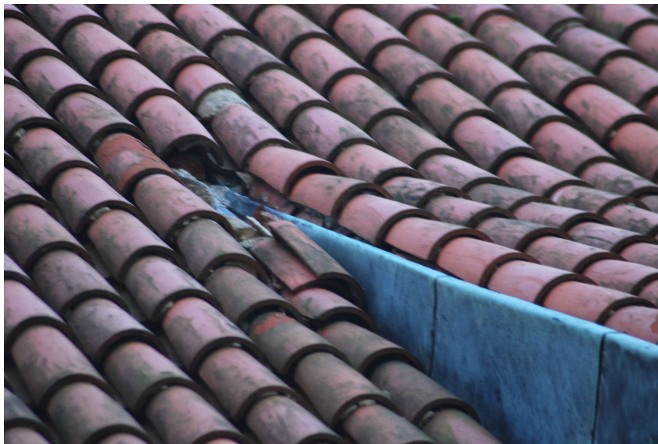
fot. 18 – uszkodzone dachówki przy blacharce lukarny od strony północnej
